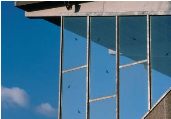
Vitrage de protection contre le vent avec un marquage inefficace fait de silhouettes de rapaces
